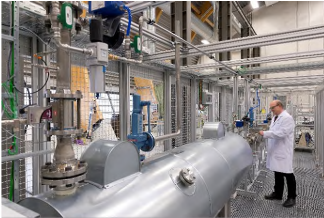
Abb. 1 Dr. Florian Mayer bei der Messvorbereitung am Bleed Air Contamination Simulator
